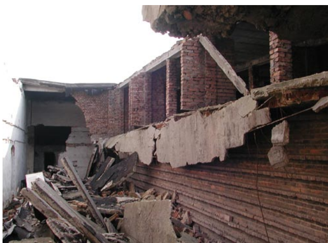
Rys. 15. Przykład zawalenia się żelbetowej konstrukcji stropu i dachu
