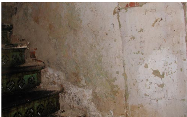
Rys. 4. Przykład zagrzybionej ściany i biegu schodowego
