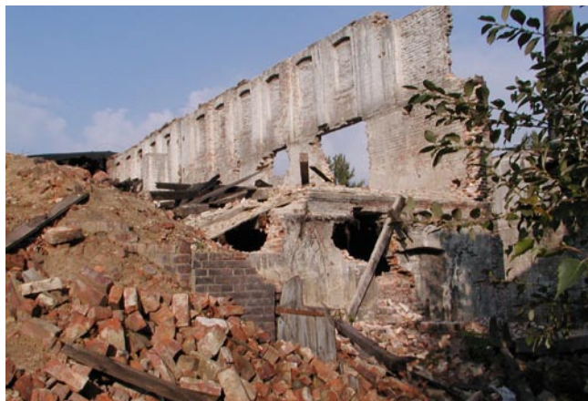
Rys. 13. Jedyna ocalała ściana pierwszego z budynków piecowni
