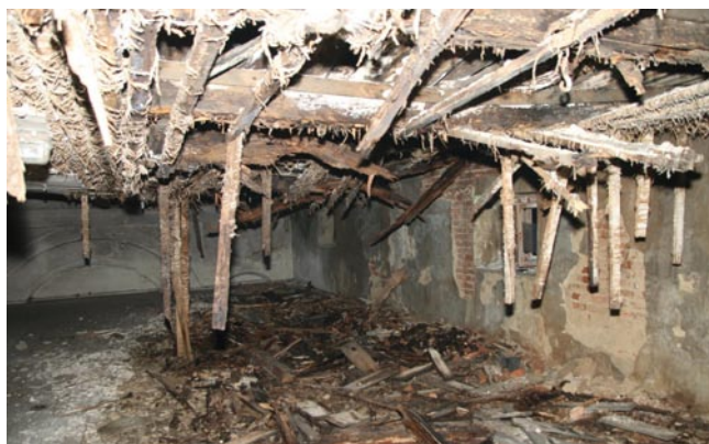
Rys. 12. Przykład zniszczenia stropu
