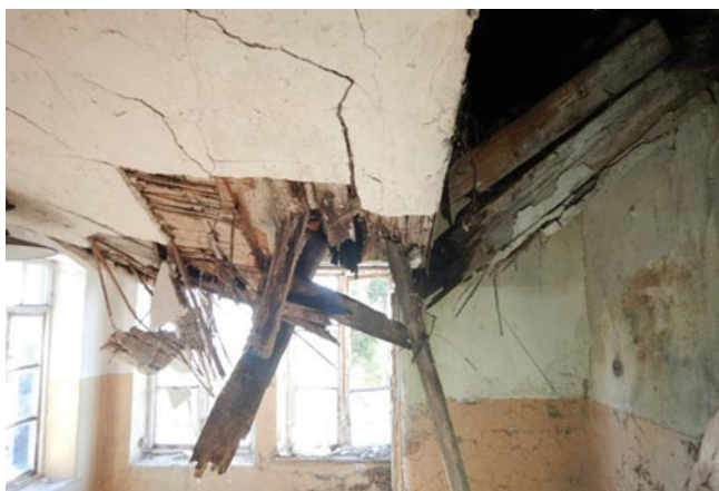
Rys. 8. Przykład zniszczenia stropu drewnianego
