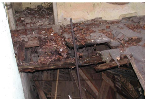
Rys. 2. Fragment zawalonego stropu
