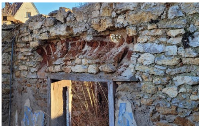
Rys. 10. Przykład zniszczonego nadproża łukowego
