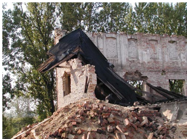
Rys. 16. Naroże budynku, zniszczone bezpośrednio po oględzinach
