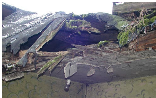
Rys. 1. Fragment zawalonego dachu budynku
