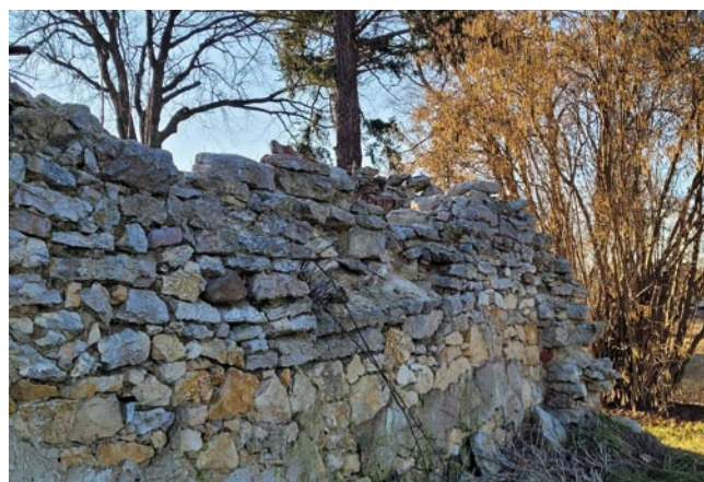
Rys. 9. Rozluźnienia struktury ścian
