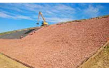
Budowa S7, odc. Miłomłyn - Olsztynek Dostawa i montaż 30 tys m 2 materacy w ciągu 3 miesięcy
