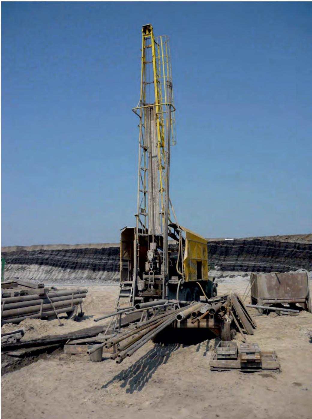
Fig. 5. Situation of core drilling in the overburden cut of the Vršany Mine Rys. 5. Wiercenie rdzeniowe otworów w piętrach nadkładowych w kopalni Vršany
