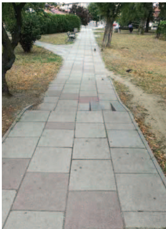
Rys. 1. Stopień na chodniku przechodzącym przez park (nieoznaczony, przy słabym świetle mało widoczny)
