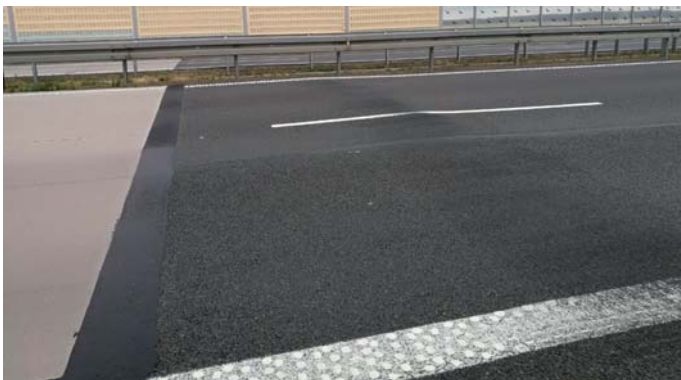
Fot. 9. Uszkodzenie nawierzchni asfaltowej – deformacje skośne do osi jezdni, w sąsiedztwie z nawierzchnią betonową. Autostrada A4 [15]
