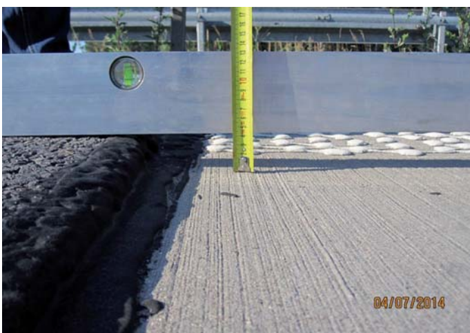
Fot. 4. Uszkodzenie nawierzchni asfaltowej – wyruszenia i pełzanie nawierzchni na styku z nawierzchnią betonową. Autostrada A4 [15]
