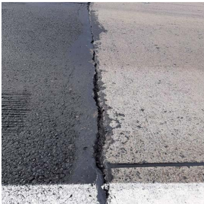
Fot. 14. Uszkodzenie nawierzchni z betonu cementowego – wykruszenia i ubytki krawędzi nawierzchni płyt granicznych z nawierzchnią asfaltową. Autostrada A18 [15]
