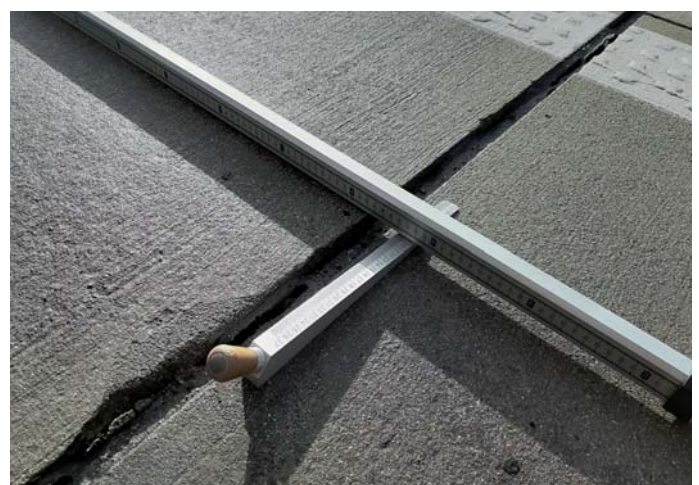
Fot. 13. Uszkodzenie nawierzchni z betonu cementowego – klawiszowanie płyty granicznej z nawierzchnią asfaltową. Autostrada A4 [15]
