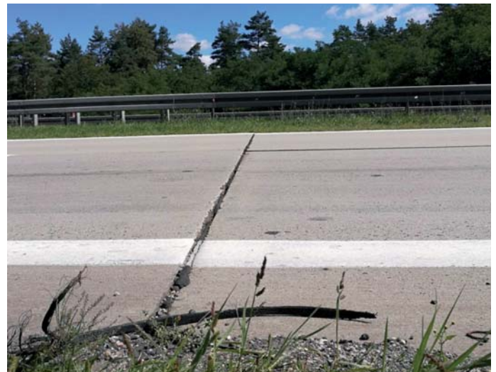
Fot. 12. Uszkodzenie nawierzchni z betonu cementowego – klawiszowanie płyty granicznej z nawierzchnią asfaltową. Autostrada A18 [15]
