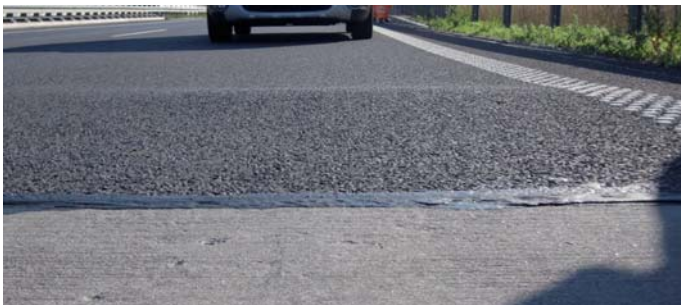
Fot. 7. Uszkodzenie nawierzchni asfaltowej – deformacje poprzeczne nawierzchni w sąsiedztwie z nawierzchnią betonową. Autostrada A4 [15]
