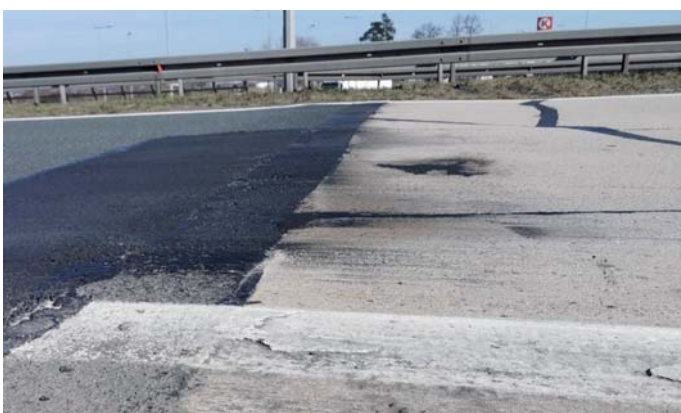
Fot. 10. Uszkodzenie nawierzchni z betonu cementowego – spękania poprzeczne i skośne płyt granicznych – niekontrolowany podział płyt nawierzchni graniczących z nawierzchnią asfaltową. Autostrada A4 (dawniej A12) [15]
