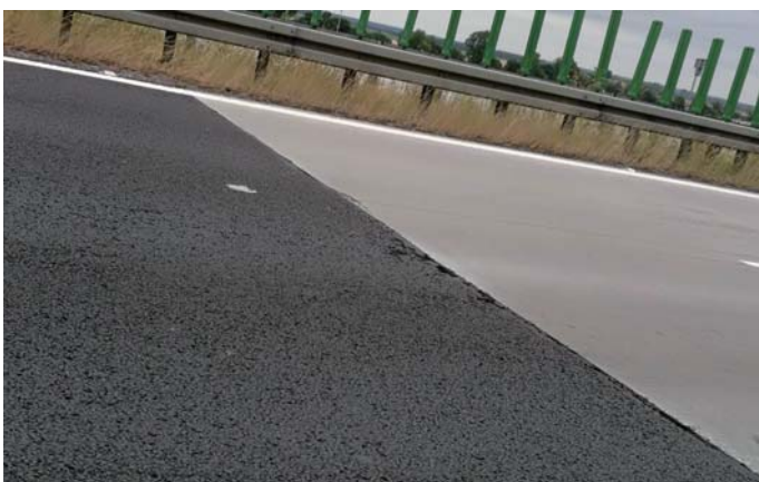
Fot. 3. Uszkodzenie nawierzchni asfaltowej – wyruszenia krawędzi i ubytki na styku z nawierzchnią betonową. Autostrada A4 [15]
