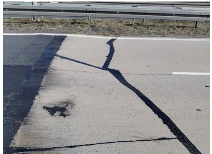
Fot. 11. Uszkodzenie nawierzchni z betonu cementowego – niekontrolowany podział płyt nawierzchni graniczących z nawierzchnią asfaltową. Autostrada A4 (dawniej A12) [15]
