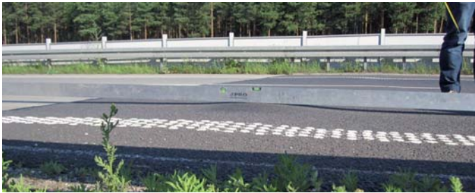
Fot. 8. Uszkodzenie nawierzchni asfaltowej – deformacje poprzeczne nawierzchni w sąsiedztwie z nawierzchnią betonową. Autostrada A4 [15]
