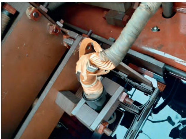
Rys. 4b. Defekt ujawniony podczas rewizji
