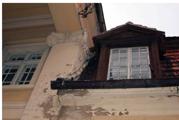
Ryc. 19. Pałac w Bieganowie, elewacja frontowa, zły stan rynien, rur stowych, dachówki i stolarki okiennej, stan obecny. Źródło: zbiory prywatne J.J. Białkiewicz
