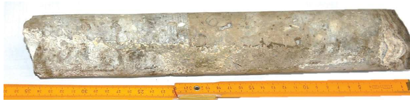
Rys. 6. Widok rdzenia pobranego z obmurza szybu w rejonie poziomiu I Fig. 6. Core taken from the shaft lining at the level I
