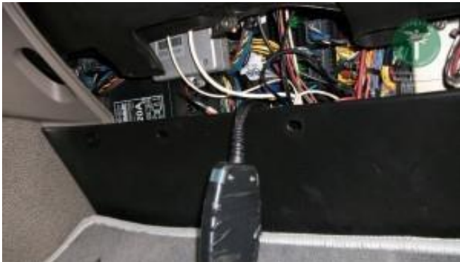
Rys.4. Nielegalny emulator pompy AdBlue w skrzynce bezpieczników
