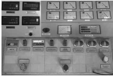
Rys. 6. Fragment dawnej nastawni z aparaturą kontrolno-pomiarową
