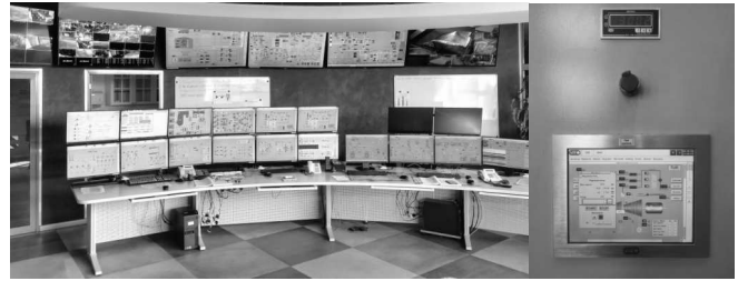
Rys 8. Fragment nowoczesnej nastawni systemu DCS MASTER z monitorami LCD oraz widok panelu dotykowego
