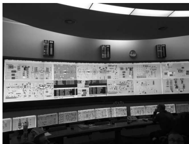
Rys. 7. Fragment nowoczesnej nastawni systemu DCS MASTER z implementacją ściany graficznej
