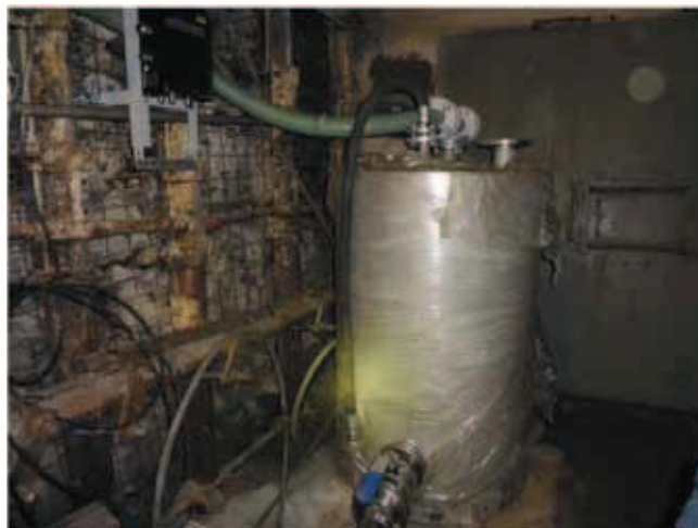
Rys. 3. Zbiornik na kondensat z procesu PZW
