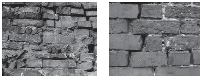
Rys. 2. Stadia degradacji zaprawy w spoinach murów ceglanych
