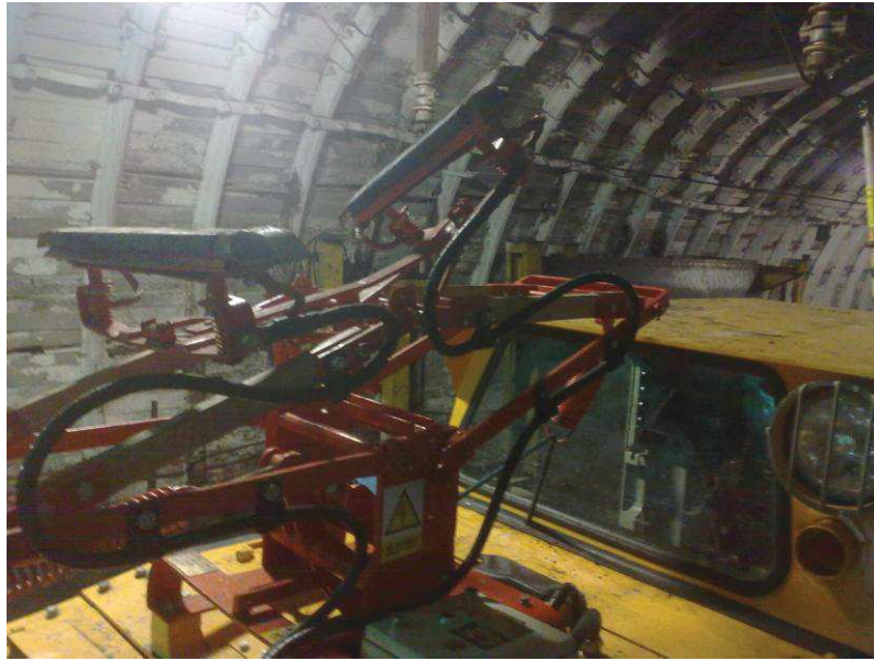
Rys. 7. Uszkodzenie odbieraka prądu [2]
