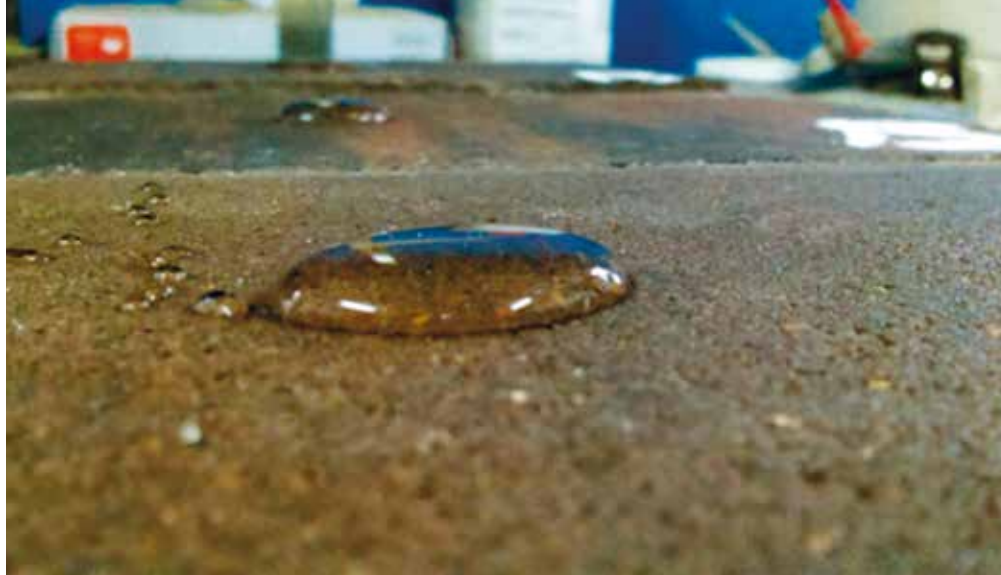
Fot. 2. Efekt hydrofobizacji betonu; zdjęcie ze zbioru własnego autora
