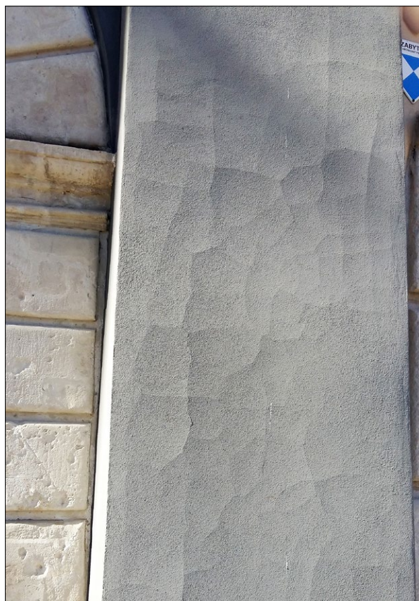
Ryc. 3. Spękane i rozwarstwione intonaco w dolnej partii elewacji kamienicy Montelupich na Rynku Starego Miasta, strona Dekerta, rok 2020; fot. T. Sawicki.
