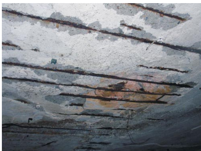
Rys. 6. Widok uszkodzonych przez korozję prętów zbrojeniowych płyty stropowej nad piwnicą
