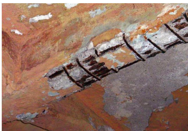
Rys. 5. Uszkodzenia korozyjne zbrojenia belki stropowej oraz betonu otuliny stropu nad parterem
