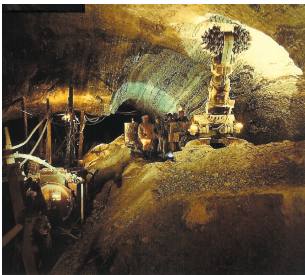
Rys. 1. Wykorzystanie kombajnu AM-50 przy przebudowie wyrobisk Komory „Ważyn” (fot. zbiory Kopalni Soli „Bochnia”)
