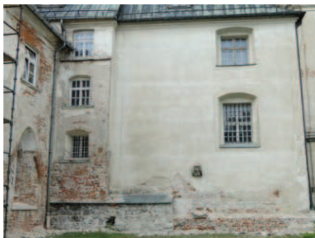
Rys. 4. Fragment ściany od strony kościoła z wyraźnie podwyższoną wilgotnością zanotowaną w pobliżu rury spustowej
