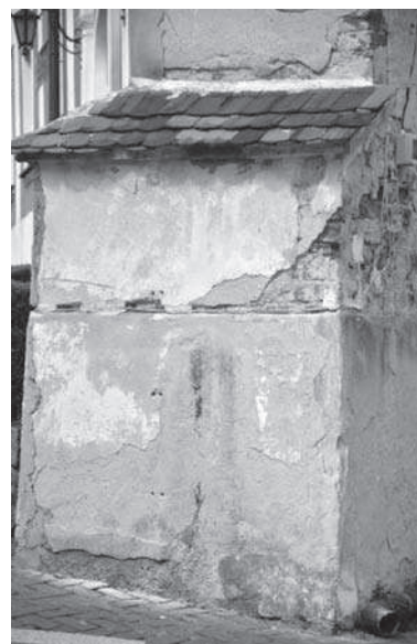
Rys. 3. Dolny fragment przypory przylegającej do ściany południowej z widocznymi otworami po wykonanych pomiarach wilgotności oraz odbarwieniem części przygruntowej będącym efektem działania wilgoci pochodzenia kapilarnego
