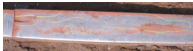
Rys. 6. Rozległy defekt o długości 600 mm będący prawdopodobnie wadą materiałową ze znacznymi deformacjami trwałymi główki szyny stwierdzony dla torowiska podpory długiej po stronie wewnętrznej pomiędzy osiami 80-81 [1].
