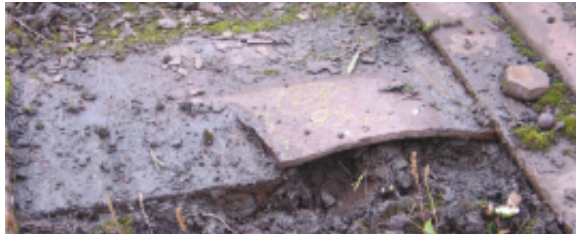
Rys. 7. Deformacja o strzałce f=85 mm oraz pęknięcie na ok. 40% przekroju płaskownika ustalającego szyny torowiska podpory krótkiej pomiędzy osiami 28-29 [1].
