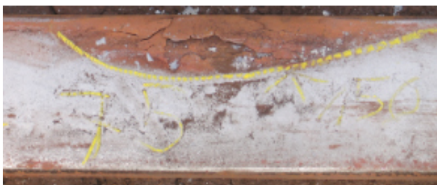
Rys. 4. Wykruszenia o długości 75 mm z deformacjami trwałymi główki szyny torowiska stwierdzone po stronie wewnętrznej torowiska podpory długiej pomiędzy osiami 75-76 [1].
