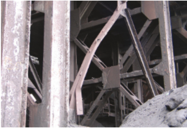
Rys. 11. Odspojenie dolnego końca i deformacja krzyżulca od strony wewnętrznej o strzałce f=33\text{mm} pomiędzy słupami w osiach 135-136 [1].
