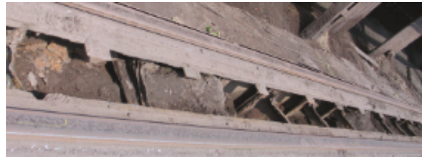
Rys. 10. Deformacje, perforacje i ubytki korozyjne dochodzące lokalnie do 90% stwierdzone dla wszystkich elementów stężących belki torowiska pomiędzy osiami 121-127,5 – obszar belki pomiędzy szynami zasypany skamieniałym pyłem [1].
