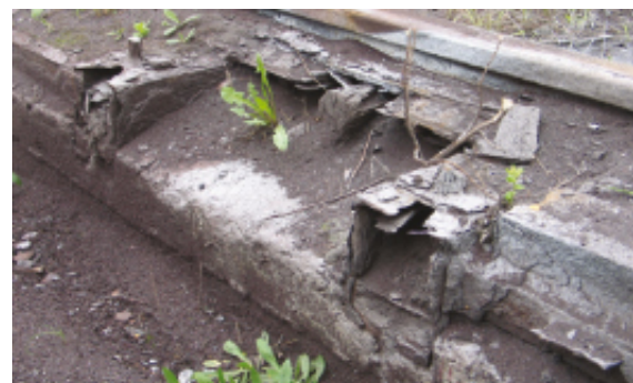
Rys. 2. Liczne perforacje i znaczne pocienienie elementów torowiska podpory długiej w osiach 144-146 [1].
