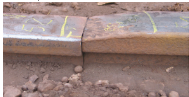
Rys. 5. Wzajemne przesunięcie pionowe o \Delta V=6 mm i poziome o \Delta H=5 mm styku szyn z deformacjami główki szyny stwierdzone po stronie wewnętrznej torowiska podpory długiej pomiędzy osiami 51-52 [1].
