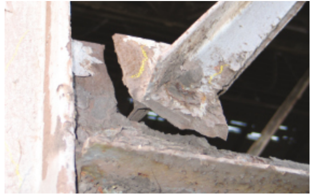
Rys. 12. Deformacje, perforacje i ubytki korozyjne dochodzące lokalnie do 90% stwierdzone dla wszystkich elementów stężących belki torowiska pomiędzy osiami 121-127,5 – obszar belki pomiędzy szynami zasypany skamieniałym pyłem [1].
