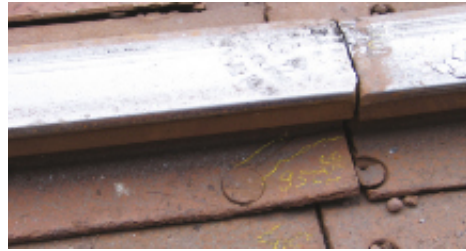
Rys. 8. Pęknięcie stopy szyny o długości 95 mm od otworu nitu stwierdzone dla wewnętrznej szyny torowiska podpory krótkiej pomiędzy osiami 45-46 [1].
