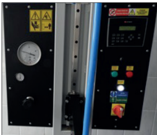
Rys. 8 Wskazanie manometru podczas próby szczelności (1,0 bar)
