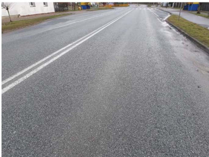
Fot. 2. Widok ogólny nawierzchni ul. Szczecińskiej po 18 latach eksploatacji
