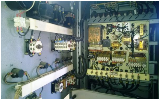
Rys. 3. Wnętrze tablicy kontrolnej agregatu prądowłórczego
