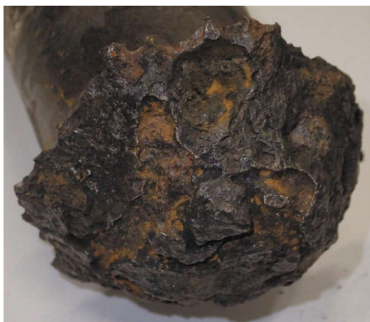
Rys. 4. Łeb śruby pobranej ze złącza poziomego obudowy tubingowej, 21% zachowania objętości normowej łba
