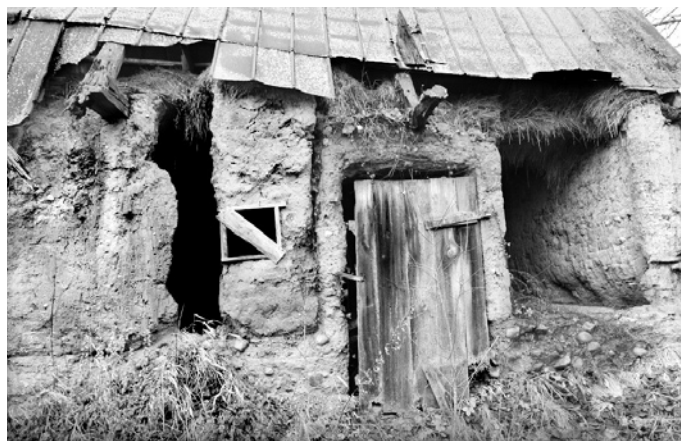
Ryc. 1. Zniszczony budynek gospodarski w Daniłowcach w gminie Giby; źródło: fot. autorzy, 2016
