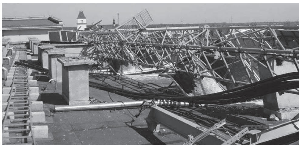
Rys. 1. Widok wzdłuż zwalonego masztu
