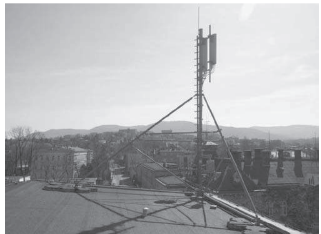
Rys. 3. Konstrukcja wsporcza anten telefonii komórkowej
