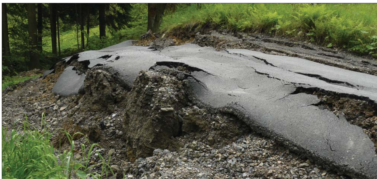
Zniszczona droga na osuwisku w Zembrzycach (powiat suski). Fot. J. Dacka Damaged tarmac road in Zembrzyce (Sucha district). Photo by J. Dacka
