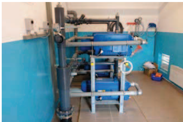
Rys. 5. Wnętrze stacji podciśnieniowej w Raczycach (zdj. własne)
