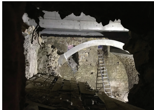
Fot. 2. Podziemia zabezpieczone żelbetową płytą w trakcie prac budowlanych (fot. A. Witeczek)
