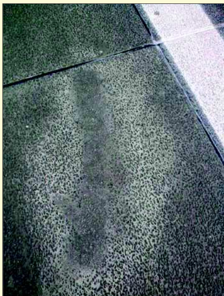
Fot. 28. Widok naprawionej wady „po kamizelce ostrzegawczej” robotnika (patrz fot. 17 w [4]) (fot. Stefan Rewiński)
