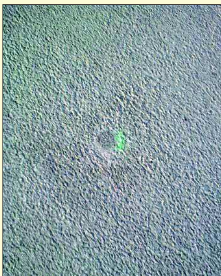
Fot. 31. Widok naprawionego bardzo małego uszkodzenia (fot. Stefan Rewiński)
