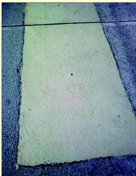
Fot. 25. Widok nawierzchni po naprawie powierzchniowego uszkodzenia zdyskwalifikowanej przez nadzór po 2 miesiącach eksploatacji (fot. Stefan Rewiński)
