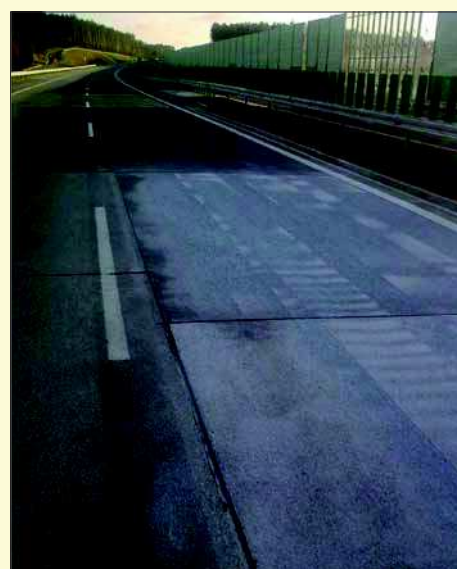
Fot. 33. Widok wymienionej (z powodu pęknięcia) płyty; widoczne przesunięcie szczelin poprzecznych może spowodować, w trakcie eksploatacji nawierzchni, powstanie pęknięć sąsiednich płyt na przedłużeniu co najmniej jednej ze szczelin poprzecznych (fot. Stefan Rewiński)
