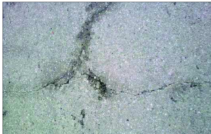
Fot. 19. Widok, po dwóch miesiącach eksploatacji, uszkodzenia na powierzchni nawierzchni z betonu cementowego zbrojonego (fot. Stefan Rewiński)
