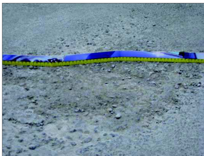
Fot. 21. Widok przykładowego uszkodzenia górnej warstwy nawierzchni z betonu cementowego o odstłoniętym kruszywie (fot. Stefan Rewiński)
