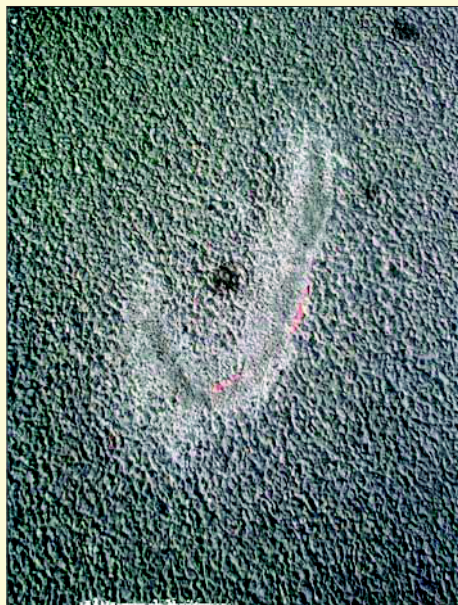
Fot. 29. Widok naprawionej powierzchni płyty po zanieczyszczeniu (po pozostawionym i wartym w powierzchnię płyty przewodzie elektrycznym) – (fot. Stefan Rewiński)
