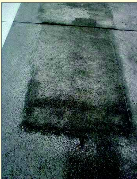
Fot. 26. Widok po naprawie uszkodzenia powierzchniowego, przeprowadzonej wg zaaprobowanej przez nadzór technologii (barwa naprawy zbliżona do betonu cementowego) – (fot. Stefan Rewiński)
