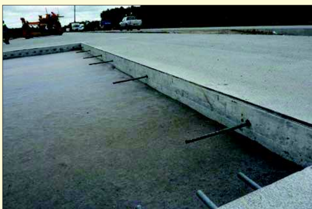
Fot. 23. Widok przygotowanego do ponownego wykonania fragmentu nawierzchni (widoczne dyble osadzone luzem, które pracują na ścinanie oraz wklejone kotwy, pracujące na wrywaniu) – (fot. Stefan Rewiński)
