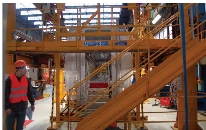
Fot. 6. Elementy składowe na tzw. „katedrze” przygotowane do spawania w pudło wagonu. Wewnątrz pudła widoczne krzyżowe rozporry zapobiegające odkształceniom pod wpływem naprężeń spawalniczych
