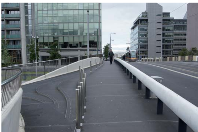
b) obwisłe chodniki przy filarze w środku mostu
