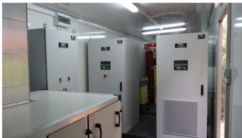
Rys. 5. Wnętrze tyrystorowej przetwornicy przewoźnej EL-TTP1 [8]
