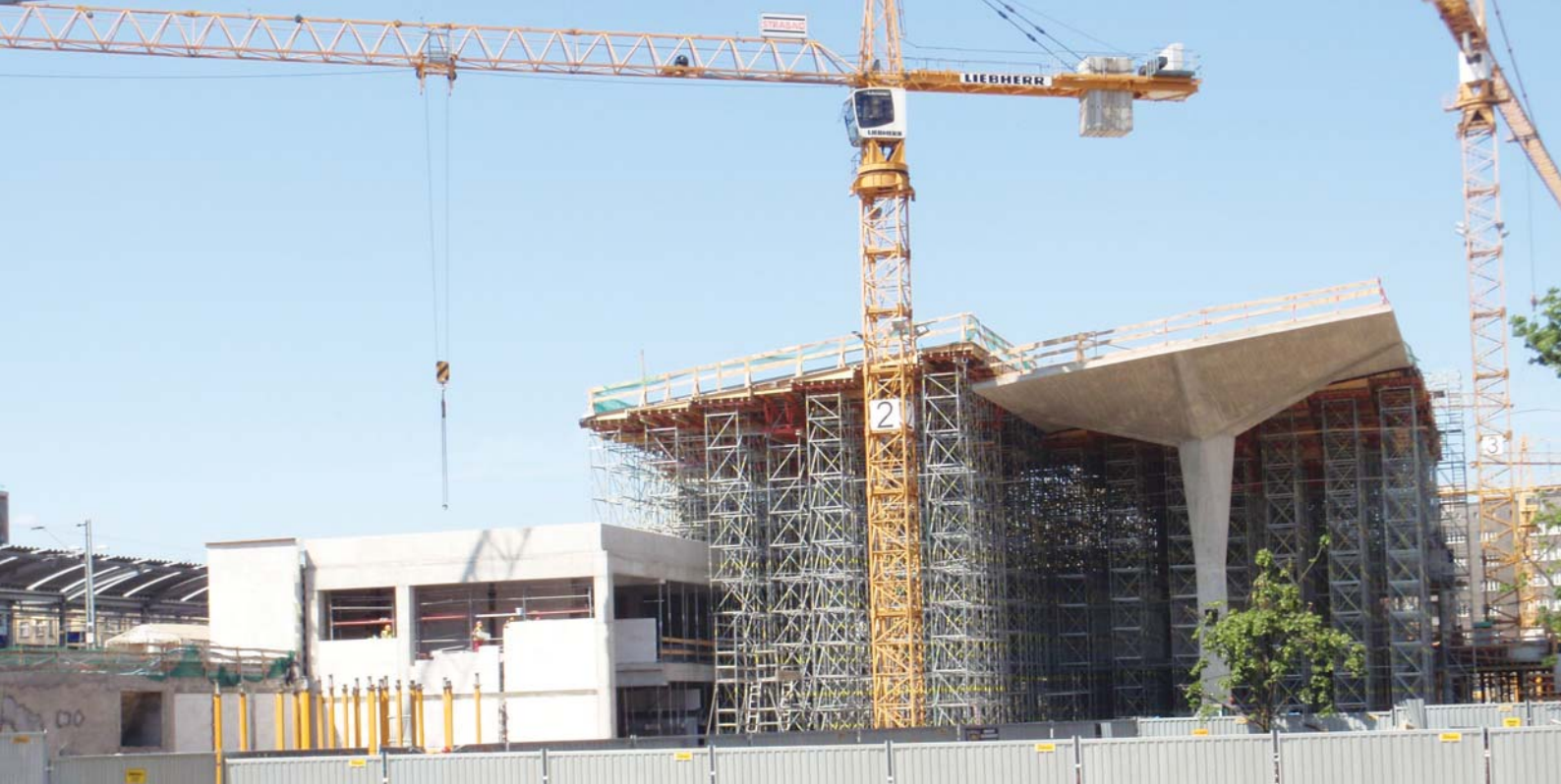
Fot. 1. Budowa nowego dworca Katowice Osobowa – ostatnie chwile, w których widać było odtworzone charakterystyczne dla konstrukcji budynku dworcowego kielichy w całej okazałości. Fot. A. Molecki
