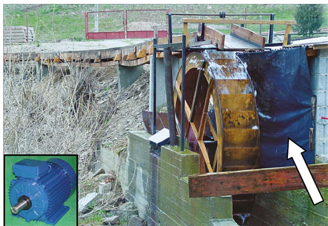
Rys. 18. Mała przydomowa elektrownia wodna w wykonaniu amatorskim o mocy 1,5 kW
