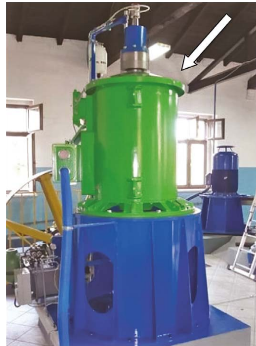
Rys. 17. Bezprze- kładniowy zespół prądotwórczy w elektrowni wodnej z ge- neratorem z magnesami trwałymi (kolor zielony - genera- tor)
