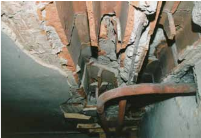
Rys. 8. Uszkodzenia stropu piwnicy w partiach przydylatacyjnych
