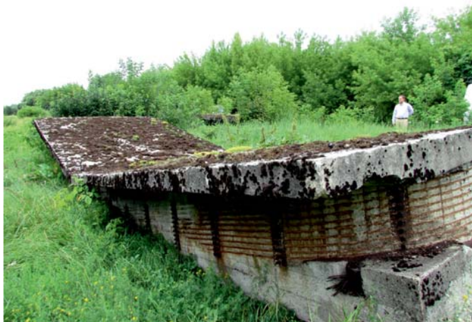
Fot. 5. Próbné przęsło po badaniach niszczących, odnalezione w sąsiedztwie mostu łukowego
