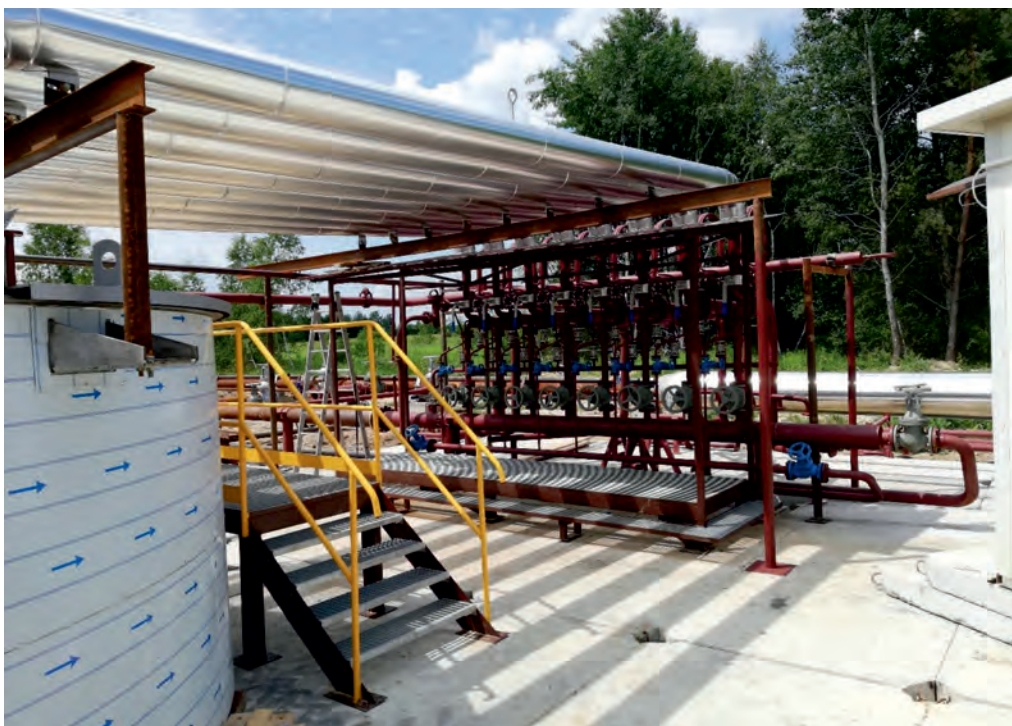
Rys. 6. Sterownia ośmiocelkowa ze zbiornikiem siarki [Polska Siarka Sp. z o. o.] Fig. 6. Control room with sulphure storage vessels
