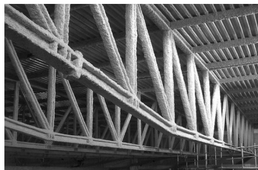
Rys.4. Kratownica zabezpieczona powłoką niereaktywną [5].
