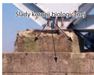
Rys. 5. Żelbetowa podpora z ogniskami korozji biologicznej
