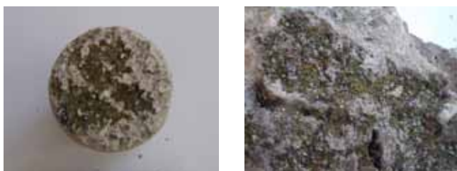
Rys. 10. Próbkki betonu z widocznymi czynnikami biotycznymi
