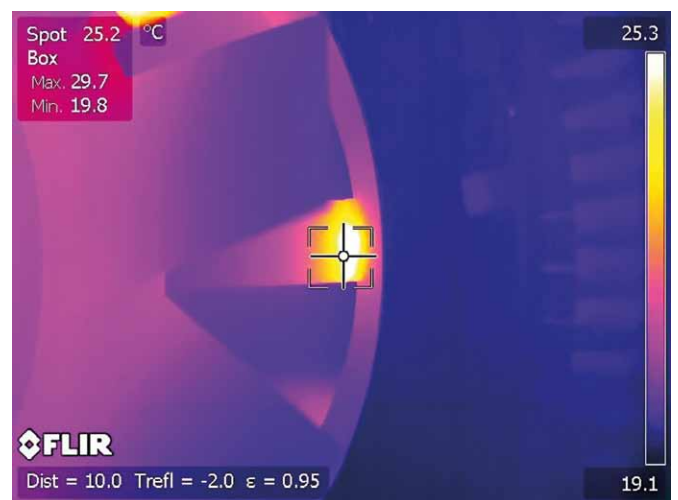
Fot. 22. Wirnik głęboko żłobkowy silnika o mocy 6,3 MW – termogram; miejsce mocowania wału wirnika
