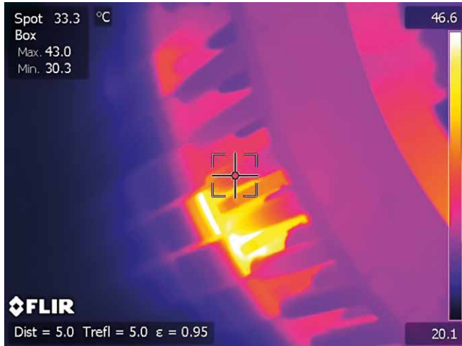
Fot. 9. Wirnik dwuklatkowy - termogram - zwarcie pręta klatki rozruchowej
