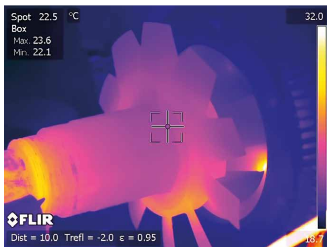
Fot. 19. Termogram wirnika głęboko żłobkowego silnika o mocy 6,3 MW
