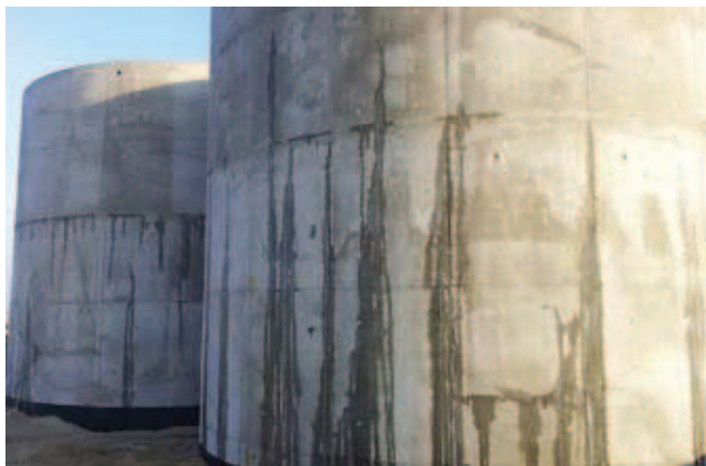
Rys. 1. Widoczny obraz zarysowań zbiorników od strony południowej (na pierwszym planie zbiornik nr 1)
