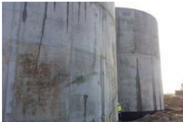
Rys. 2. Widoczny obraz zarysowań zbiorników od strony południowo-zachodniej (na pierwszym planie zbiornik nr 2)
