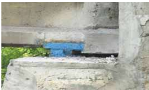
Rys. 13. Łożysko – przyczółek wschodni, strona południowa (przed remontem)
