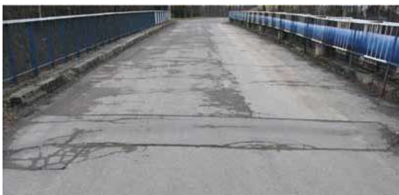
Rys. 4. Widok od strony wschodniej na jezdnię na wiadukcie i uskok
