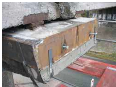
Rys. 8. Łożyska skrajne na filarze i rama stalowa (po tymczasowym remoncie)
