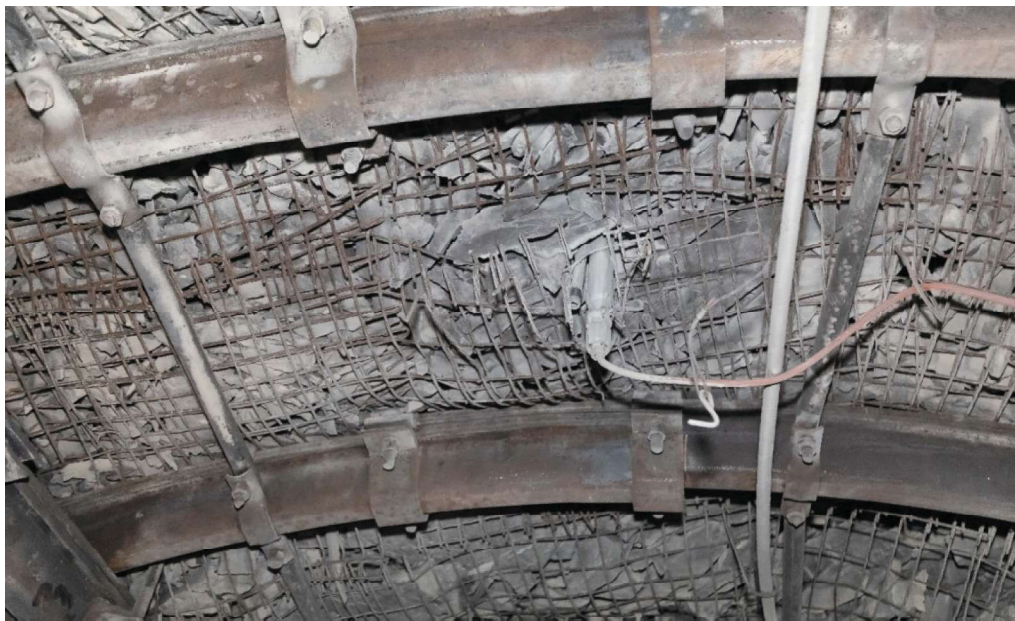
Rys. 11. Kotew pomiarowa zabudowana w stropie chodnika PW-1, widoczna końcówka pakera po instalacji
