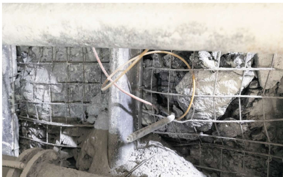
Rys. 5. Czujnik naprężeń (bialaxial stressmeter) zabudowany w ociosie chodnika, widoczna rurka odpowietrzająca po instalacji Fig. 5. Bialaxial stressmeter installed in the rib, the deaerating tube after installment is visible
