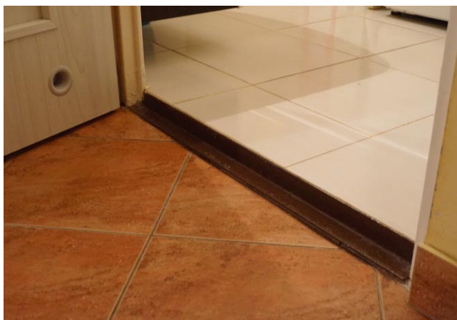
Rys. 6. Próg i wąskie drzwi (szer. 70 cm) do pomieszczenia łazienki
