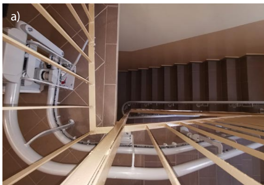
Rys. 10. Przykład wbudowania tzw. krzesła schodowego na torze krzywoliniowym; materiały przedsiębiorstwa RAV-NET Rafał Kurzyna
