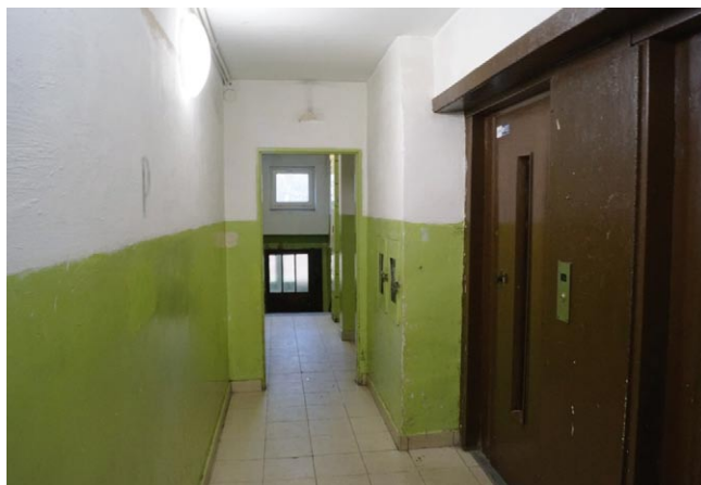
Rys. 3. Szereg barier w postaci występowania starego typu drzwi dźwigowych wymagających ręcznego otwierania, w głębi wąskiego korytarza (szer. 140 cm) oraz wąskiego przejścia (szer. 80 cm) na parterze budynku wysokiego
