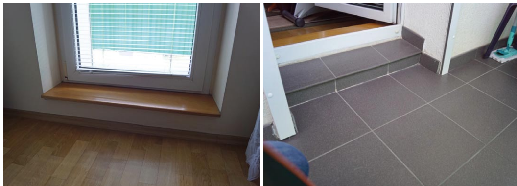
Rys. 5. Wysoki próg drzwi balkonowych
