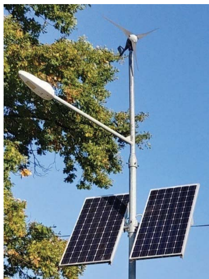
Rys. 1. Lampa oświetlenia ulicznego z zasilaniem hybrydowym z odnawialnych źródeł energii [opracowanie własne] Fig. 1. Street lighting lamp with hybrid power supply from renewable energy sources [own work]
