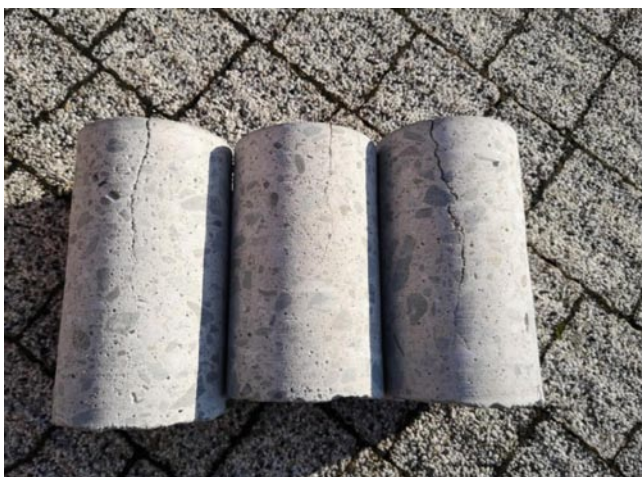
Rys. 8. Próbki betonu, odwiert przez rysy
