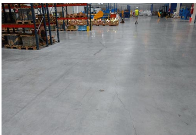
Rys. 2. Typowe rysy na obiekcie
