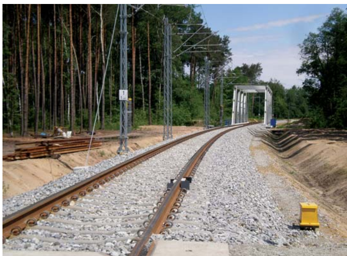
Fot. 5. Nowa łącznica Czerwieńsk Południe – Czerwieńsk Wschód umożliwiająca przejazd pociągów z Zielonej Góry w kierunku Poznania bez zmiany czoła na stacji Czerwieńsk
