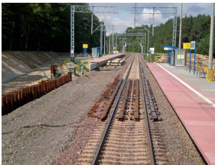
Fot. 7. Roboty przy budowie obiektów inżynierskich na szlaku Rakowice – Itawa Główna na linii nr 9 Warszawa – Gdańsk skutkujące miejscowym ograniczeniem prędkości
