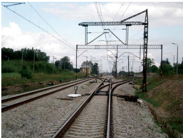
Fot. 2. Rozjazdy na stacji Jastrząb na linii nr 8 Warszawa – Kraków
