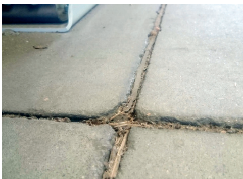
Zniszczona dylatacja na skutek zjawiska pęczenia i klawiszowania
