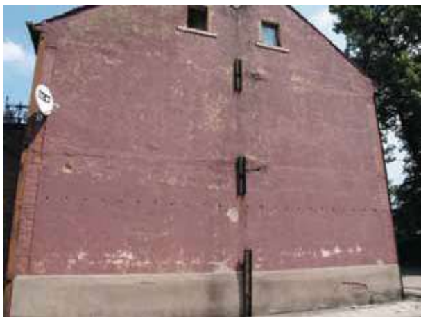
Rys. 11. Wepchnięcie do wnętrza budynku oraz poziome spękanie ściany szczytowej
