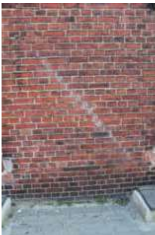
Rys. 6. Ukośne spękanie ściany podłużnej budynku
