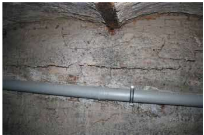
Rys. 7. Poziome spękanie wraz z wepchnięciem do wnętrza budynku ściany szczytowej
