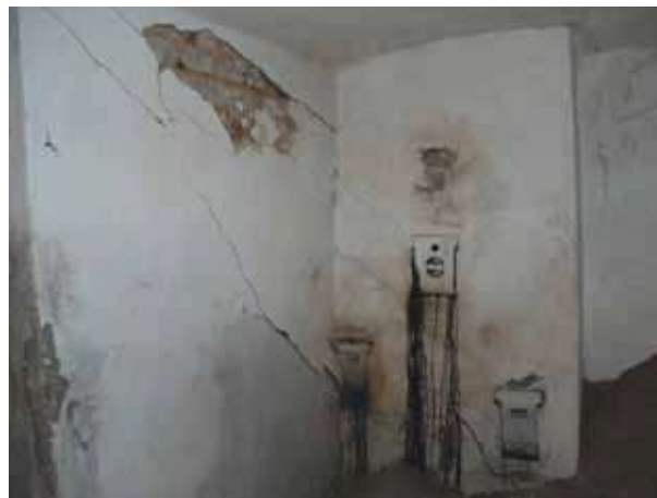
Rys. 12. Ukośne spękanie podłużnej ściany usztywniającej oraz trzonu kominowego
