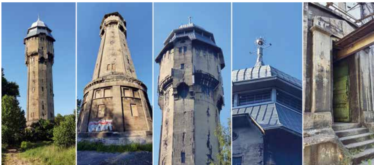
Fot. 2. Wieża „Borki” – stan zachowania: widoczne ubytki płaszcza otulającego konstrukcję, zniszczenia gzymsu wieńczącego cokół, zamurwane otwory okienne, graffiti, uszkodzone schody, a także wymienione: stolarka w górnej strefie tamburu oraz pokrycie dachów i zwieńczenie w kształcie modelu „koronawirusa”, 2022 r.; źródło: (fot. aut.)
